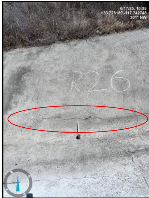
Photo 44) ¼” transverse crack on wall panel R26.
